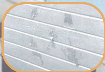
◎塗膜の剥がれがある…
