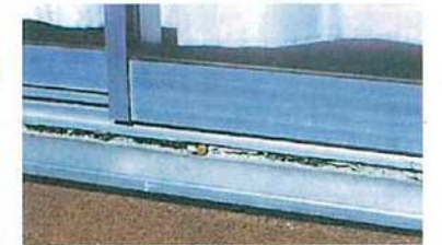
外壁・建具の周囲の劣化
