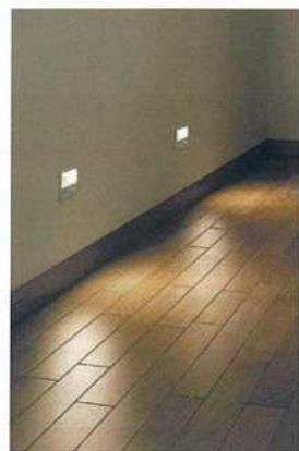
■足元灯の設置
