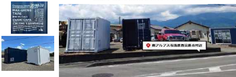
本社に展示用コンテナハウス建設中♪ 浅原橋西交差点付近にコンテナ設置中♪
